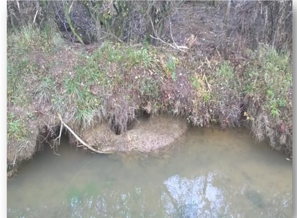
Destruction de berges par les ragondins sur le cours d'eau la Thalie.
